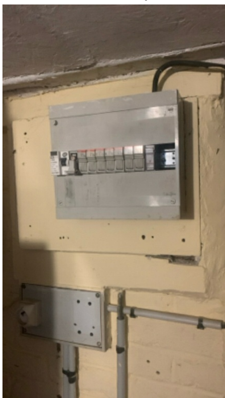
Photo du tableau électrique :
